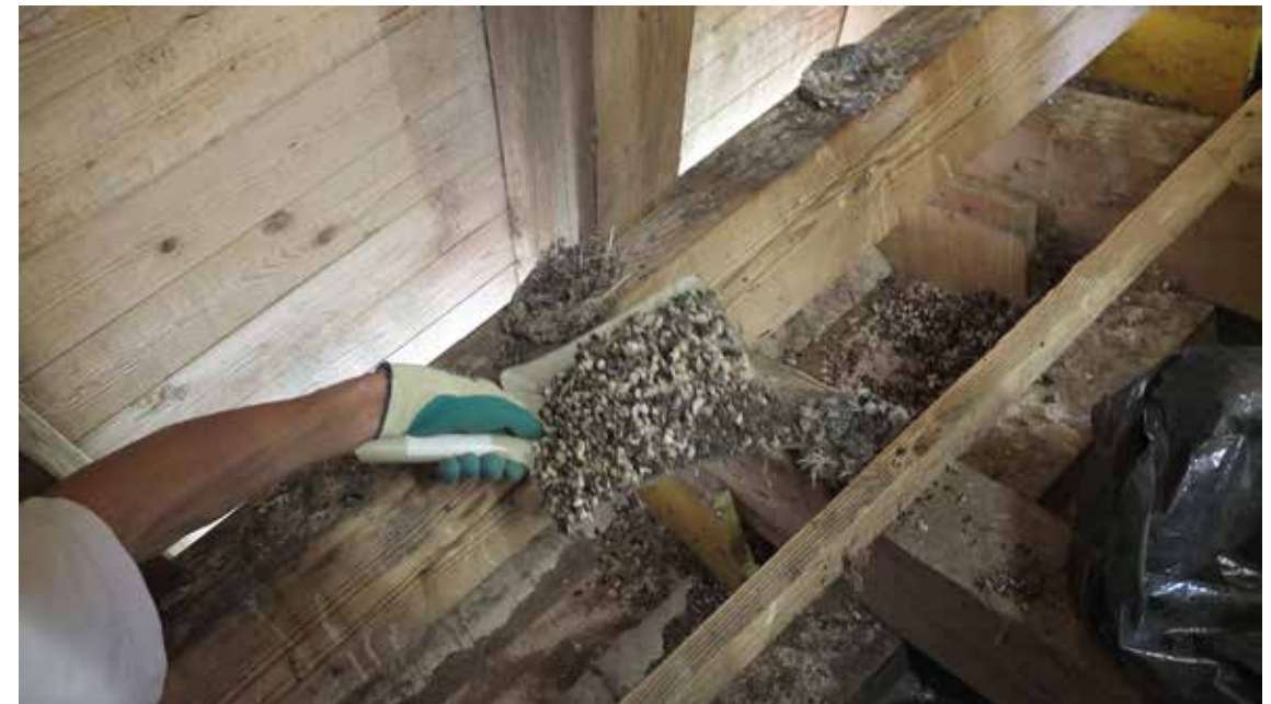
Wo möglich, wird die grosse Menge Vogelkot mit der Kehrriechtschaufel in Säcke gefüllt. In den Ecken muss der Dreck von Hand ausgebuddelt werden.
